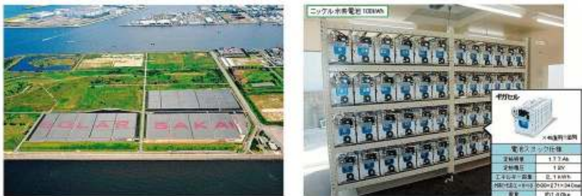
รูปที่ 2.165 : การติดตั้งแบตเตอรี่ NiMH ขนาด 100 kWh ที่โรงไฟฟ้าพลังงานแสงอาทิตย์ที่ Sakai, Okakahiura
