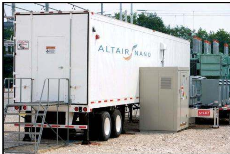
รูปที่ 4.41 : ระบบกักเก็บพลังงานโดยแบตเตอรี่ลิเทียมไอออนขนาด 1 MW/ 250 kWh ของ Altairnano (EPRI, 2010)
