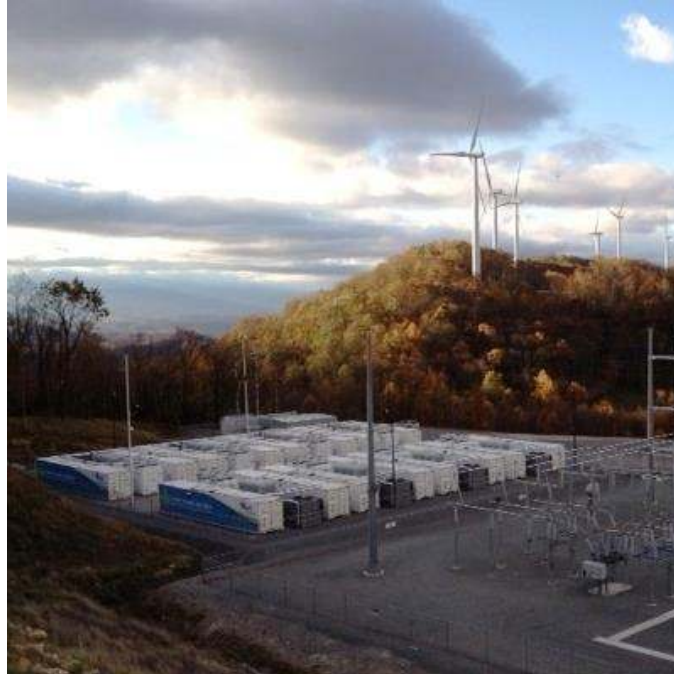
รูปที่ 2.107 : โครงการ Laurel Mountain Battery Storage ที่มลรัฐเวอร์จิเนีย
