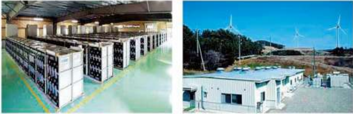
รูปที่ 2.164 : การติดตั้งแบตเตอรี่ตะกั่วกรด ขนาด 10.4 MWh ที่โรงไฟฟ้าพลังงานลมที่ Shiura
