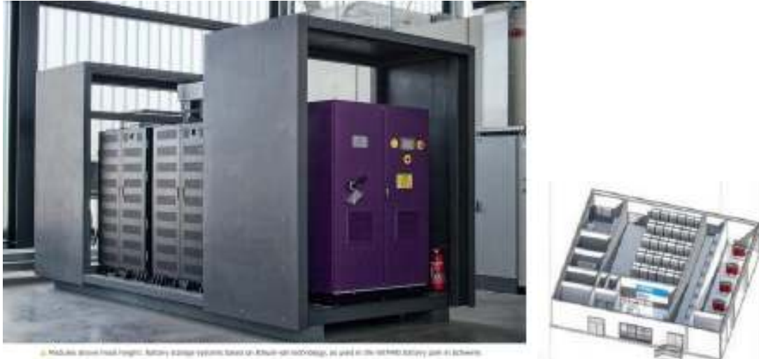
รูปที่ 2.128 : ระบบกักเก็บพลังงานด้วยแบตเตอรี่ลิเทียมไอออนที่ WEMAG Younicos Battery Park
